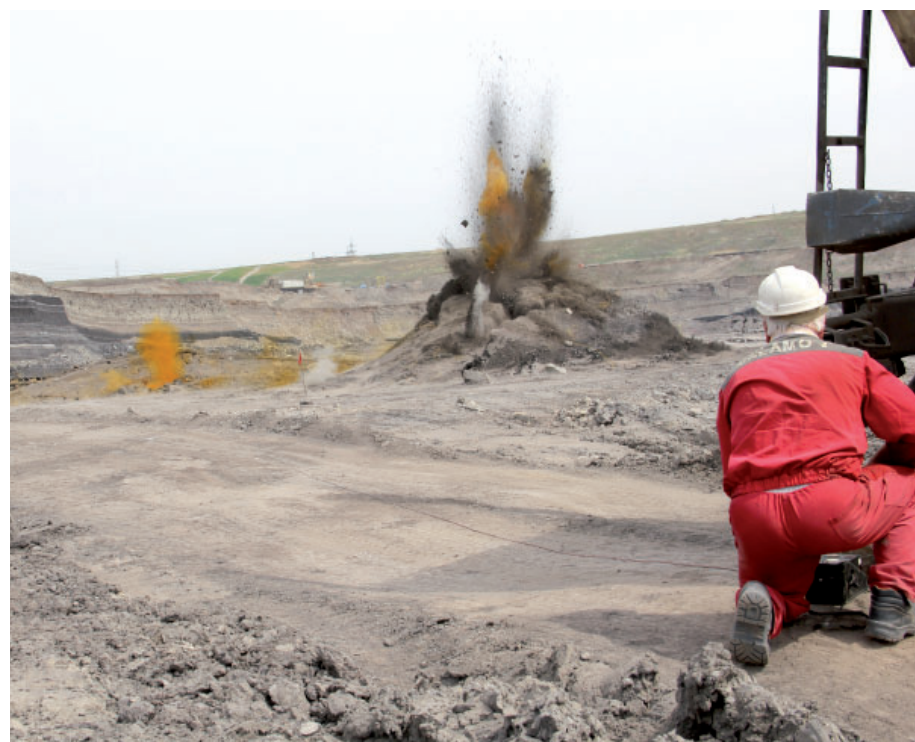
V lokalitě Vršany se odstřelují takzvané tvrdé polohy, tvořené pískovcem. Foto: (pim)
