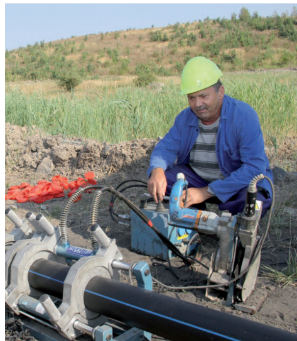
Svařování potrubí, které společnost Humeco staví od retenční nádrže ke skrápěcímu místu u velkostroje K54. Foto: (pim)
