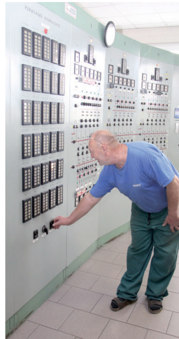
Rozvodny, jako je například ta v Lišnici, patří k nejdůležitějším energetickým uzlům. Foto: Archiv DN
