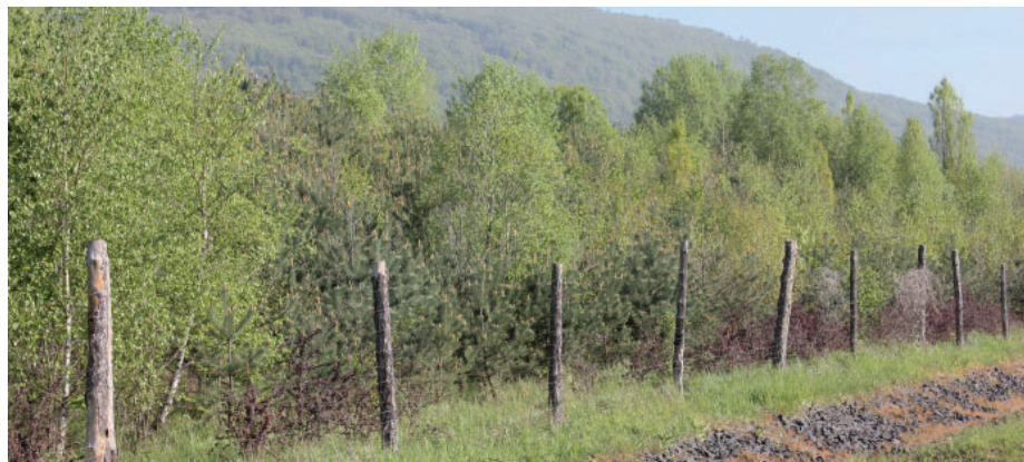
Protierozní osetí svahu u Černic. Technologie účinného ošetření svahů proti erozi v podmínkách lomu ČSA byla v Sev.en nově vyvinuta.
