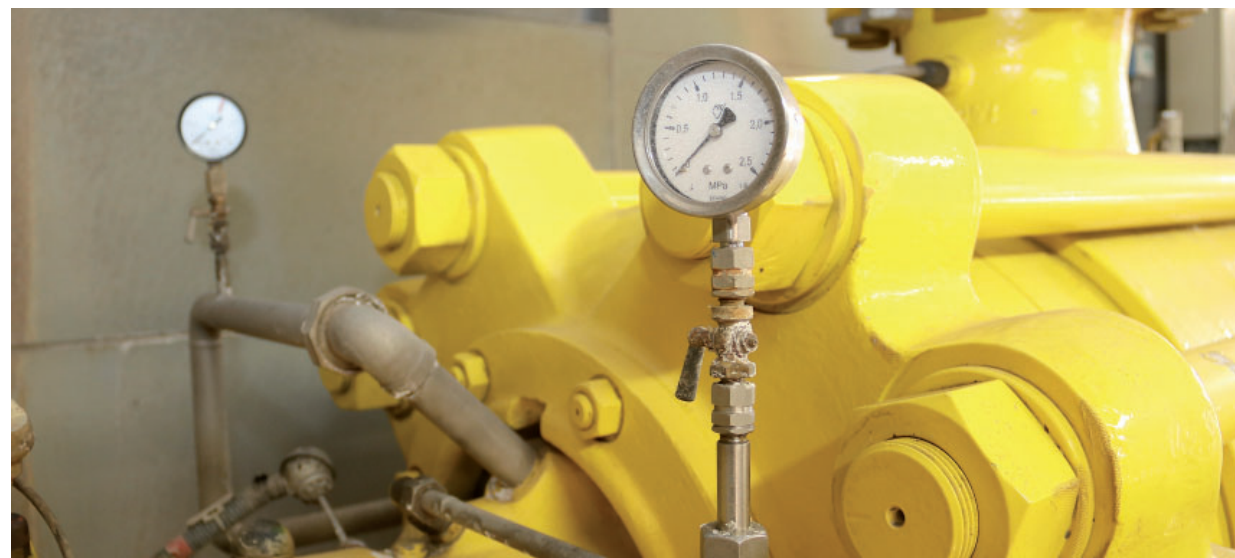
Tyhle budíky v hlavní čerpací stanici jsou manometry, které měří tlak. Foto: Archiv DN
