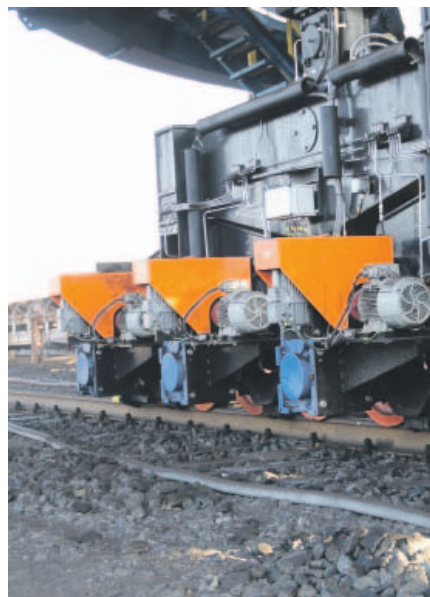
Během oprav došlo ke kompletní výměně elektro částí, tedy i pohonů pojezdu stroje, které lze nyní regulovat.
