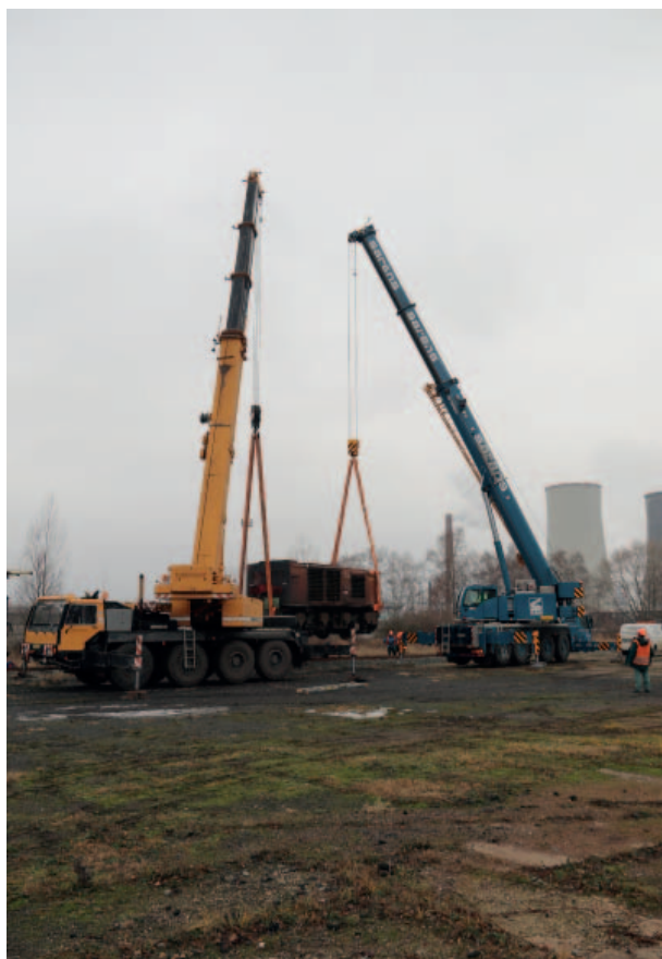
Dostat extrémně těžký stroj z kolejí také nebylo zrovna snadné. Lokomotiva se musela rozpojit na tři díly a ty se pak pomocí dvojice jeřábů přenesly a postavily přesně na dané místo.
