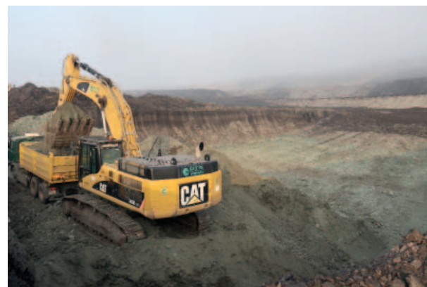
Nové jímky pro hlavní čerpací stanici ve Vršanech připravil uhelný velkostroj KU300, do patřičné hloubky je ale musí vyhloubit pomocná mechanizace. Foto: (pim)
